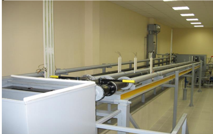
Рис. 13 Общий вид гидравлического стенда со стороны накопительной емкости
